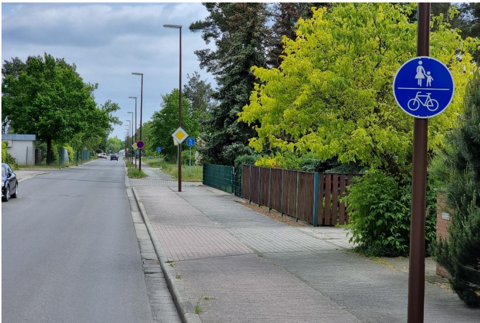
Abbildung 20: Gem. Geh-/Radweg in der Nordparkstraße mit baulichen und verkehrssicherheitsbezogenen Defiziten und zu überprüfender Anordnungsgrundlage der Benutzungspflicht (Quelle: IGS)
